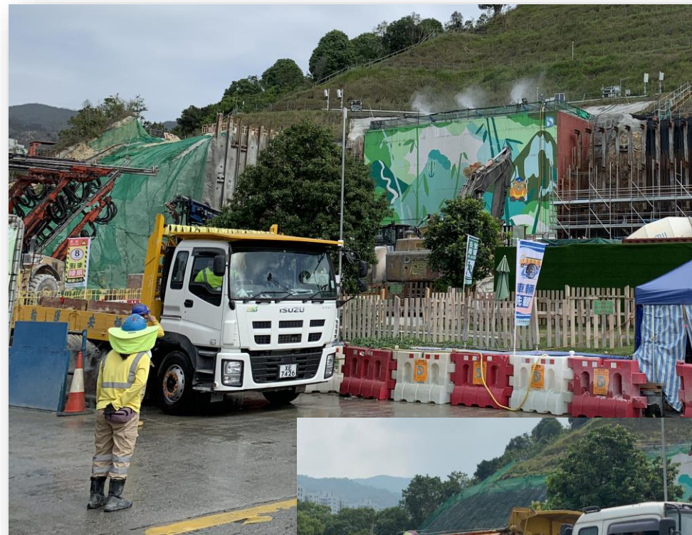
清洗車輪設施
